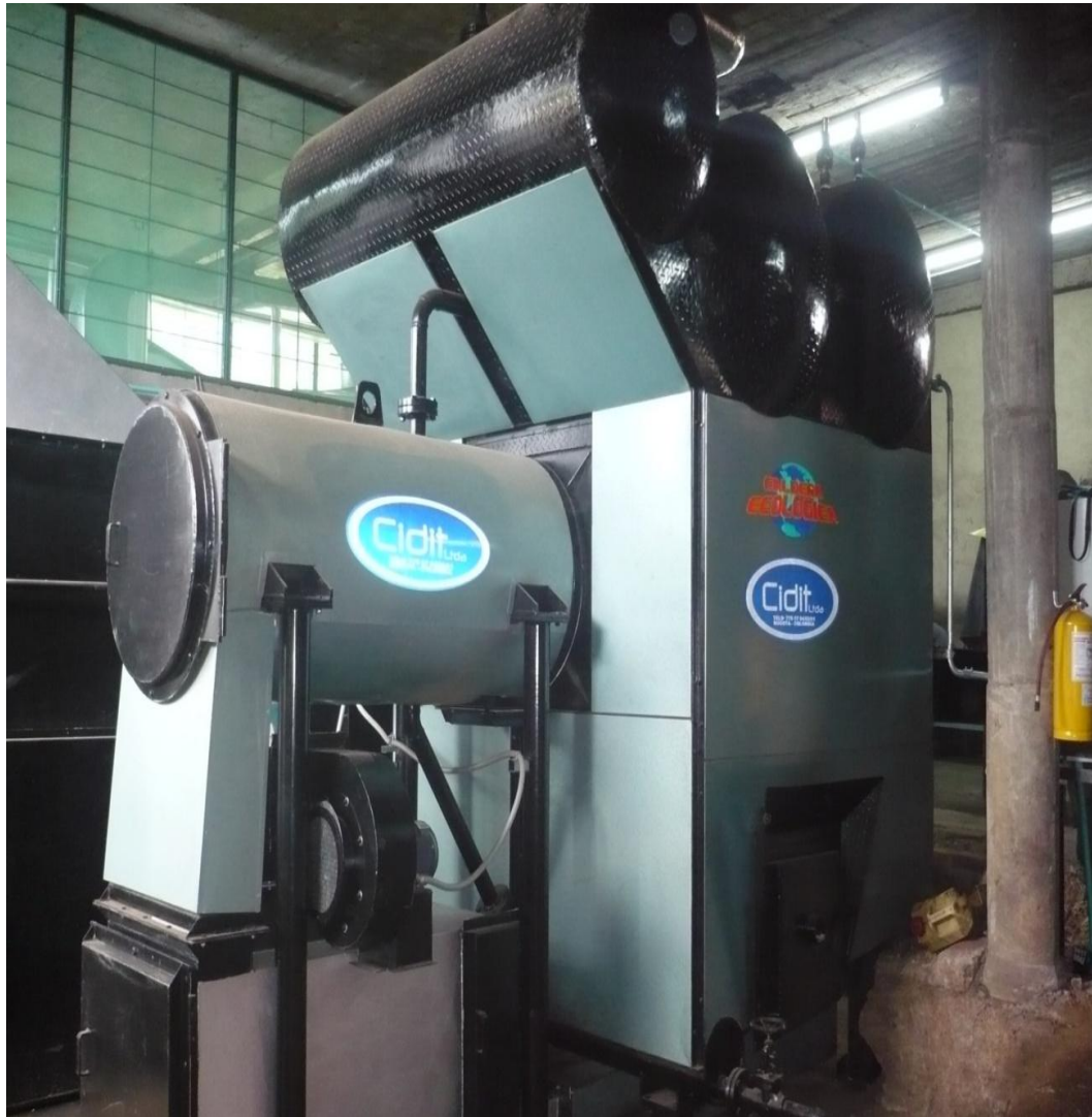
Figura 18. Caldera Sistema Panelero A Vapor
