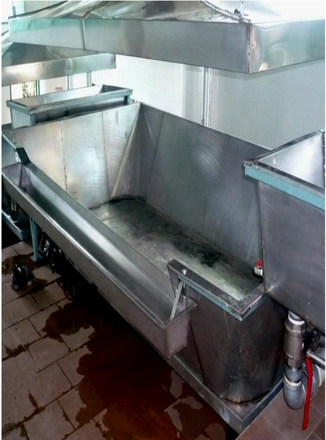
Figura 19. Evaporador. Sistema Panelero A Vapor
