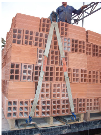
Figura 94. Estiba enganchada adecuadamente para descarga.
