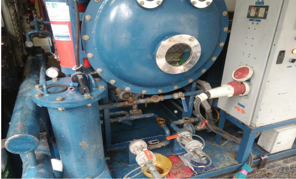
Anexo A: Cámara de vacío, filtro y tablero de control.
