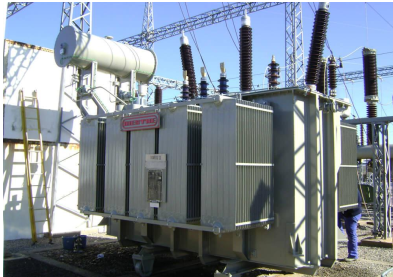
Ilustración 10. Transformador de Potencia
