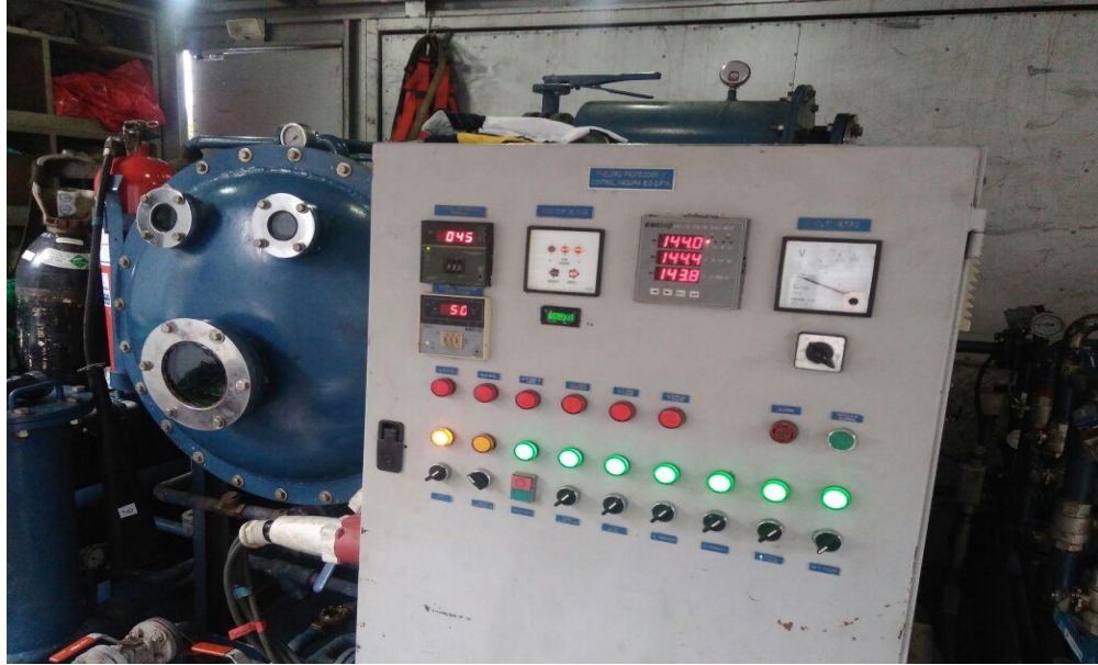
Anexo C: Tablero de control Principal.
