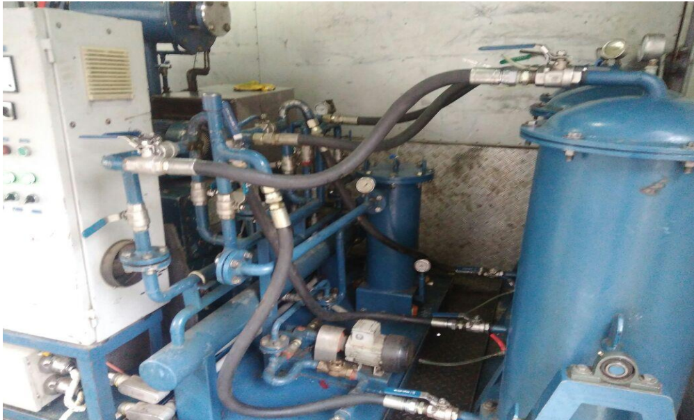
Anexo B: Mangueras de circulación – Conexión tanques de Tierra Fuller.
