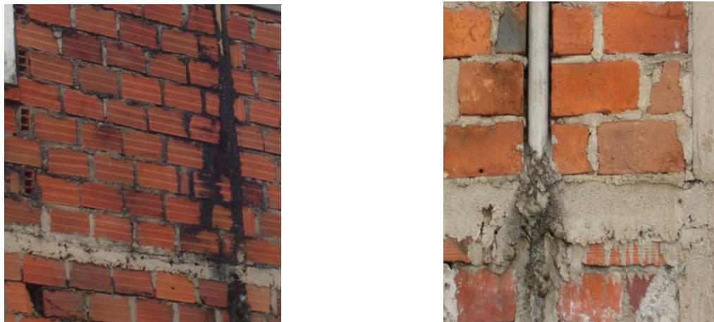
Figura 3.14. Filtraciones a causa de la tubería embebida vigas.
