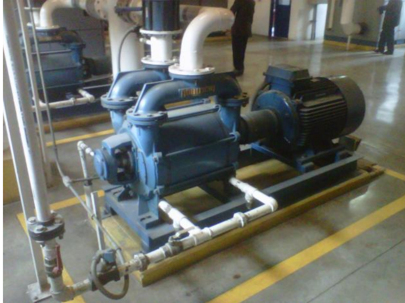
Fotografía 20. Bomba de vacío de 25 hp
