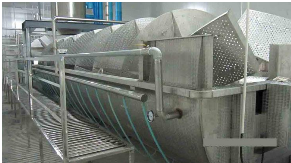
Fotografía 16. Tanque chiller de tornillo
