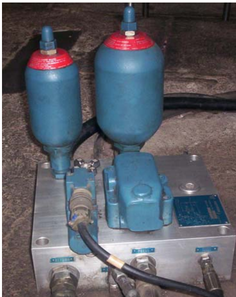
Figura 16. Manifold de Control de Fluido.
