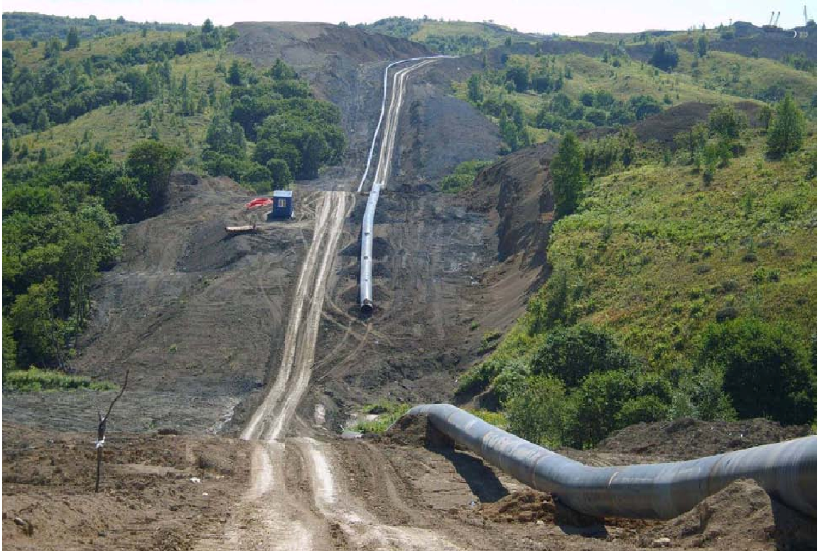
Ilustración 2.1. Colapso de tubería por causa de un deslizamiento.
