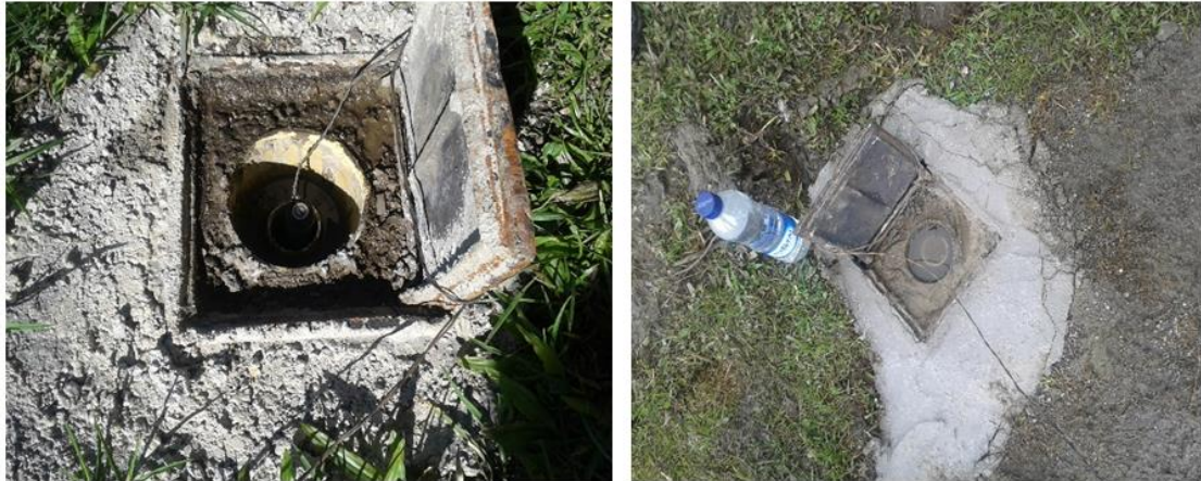
Figura 26. Piezómetros para el monitoreo de aguas subterráneas.
