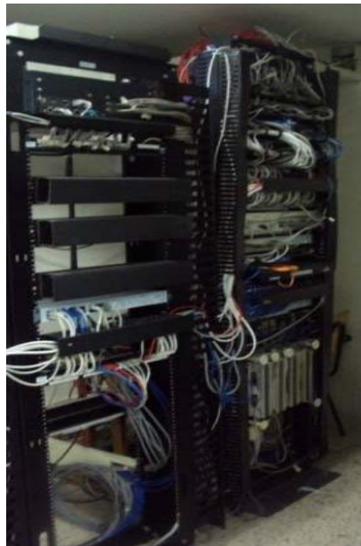
Figura12. Racks UIS Sede Barrancabermeja
