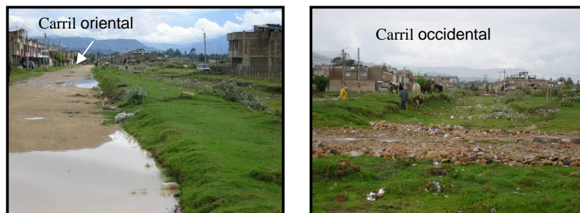
Fotografía 1. Vista panorámica y aspectos geotécnicos de los carriles oriental y occidental de la vía.
