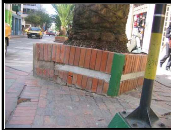
Inadecuado diseño barrera para raíces
