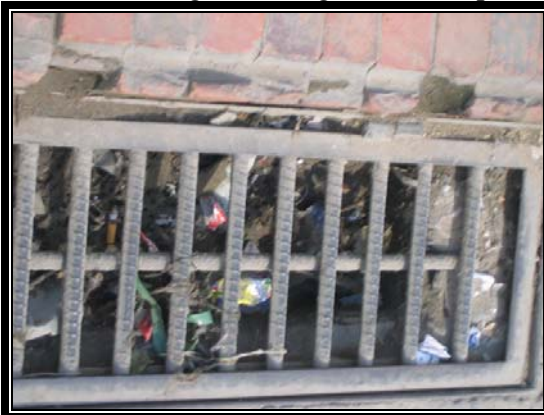
Rejillas de drenaje taponadas
