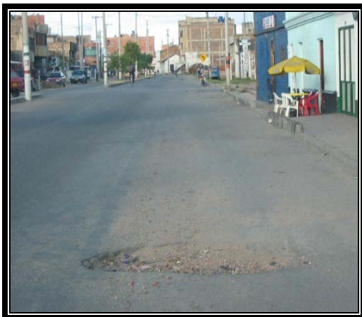
Estado de la malla vial
