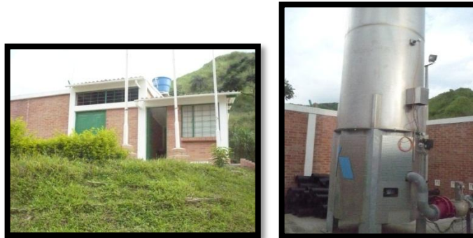
Figura 24. Planta de Tratamiento de Gases y Chimenea. Relleno Sanitario El Carrasco.
