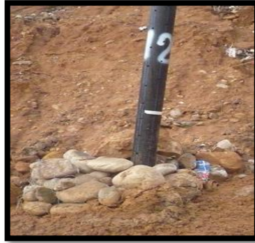
Figura 23. Chimenea. Relleno Sanitario El Carrasco.
