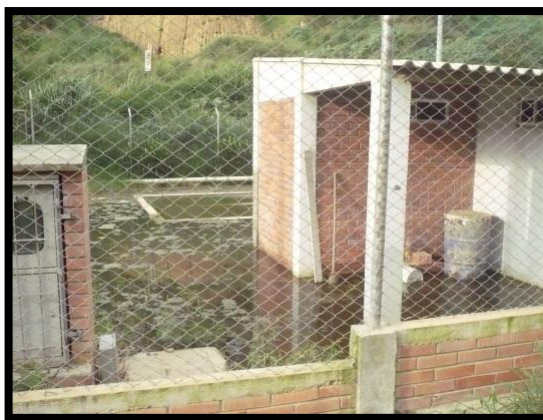
Figura 19. Nueva Planta de Tratamiento de Lixiviado. Relleno Sanitario El Carrasco.
