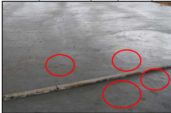
Figura 18. Abultamiento en la superficie en el primer paño de piso del Galpón N° 15
