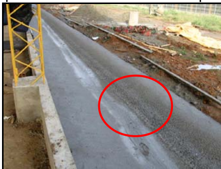
Figura 16. Desgaste de la superficie de la canaleta lateral por acción de la lluvia
