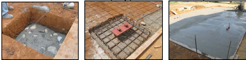
Figura 14. Cimentación en concreto ciclópeo y piso elaborada en obra para base de silos
