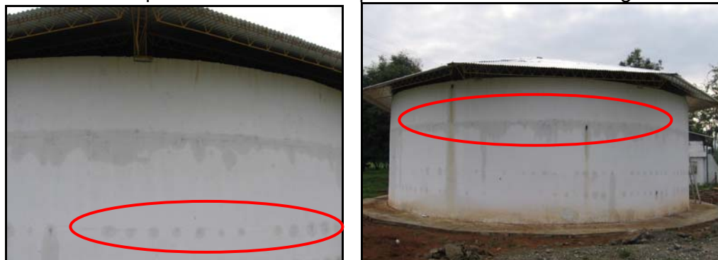
Figura 5. Filtraciones presentadas en el Tanque de almacenamiento de agua
