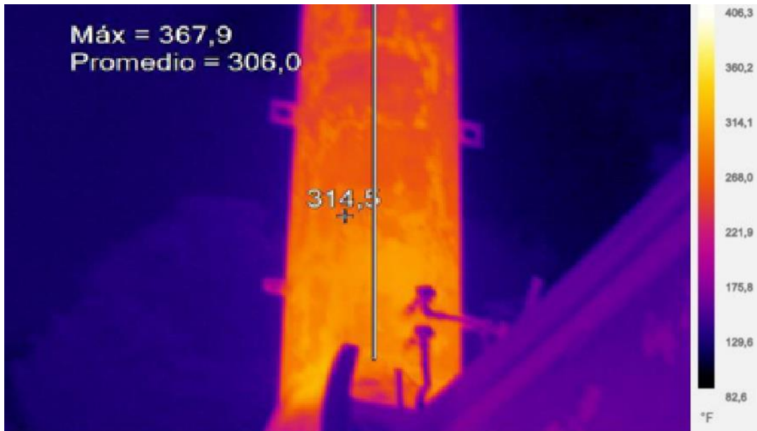
Apéndice C. Termografía de la chimenea del horno.
