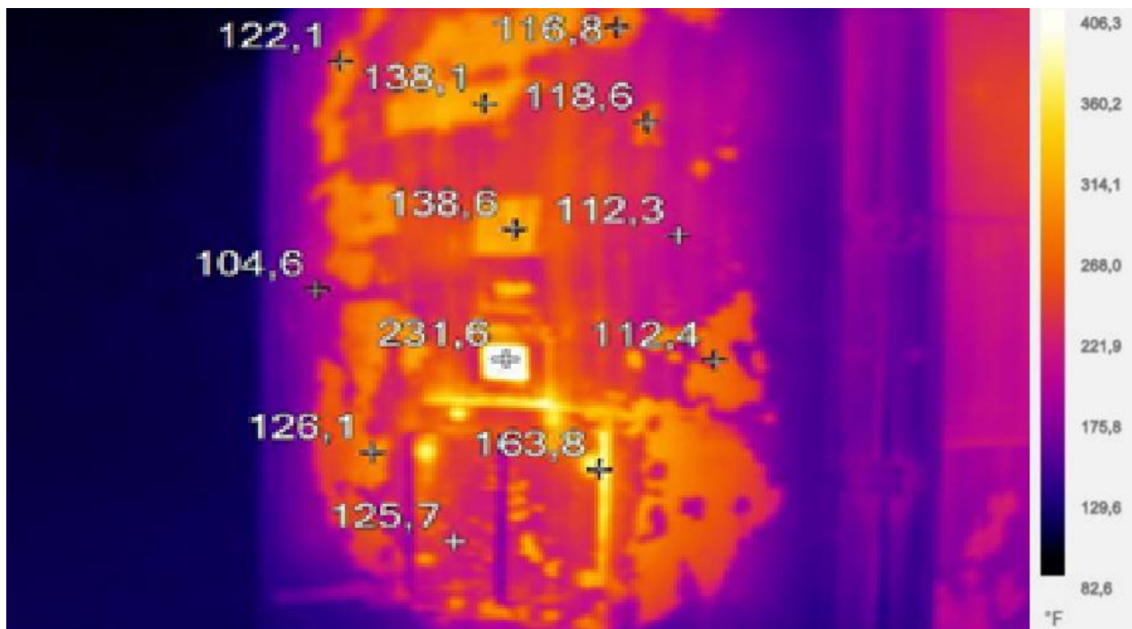
Apéndice D. Termografía frontal del horno.
