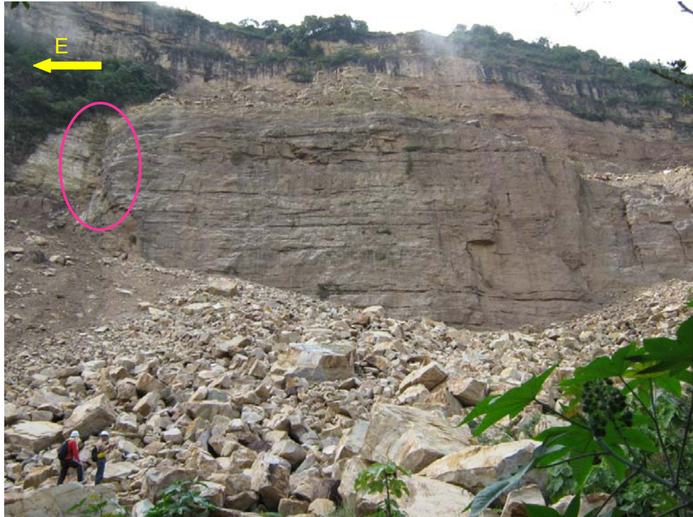
Foto 6. Costado derecho del deslizamiento, en el ovalo fucsia se muestra la humedad más relevante del talud.
