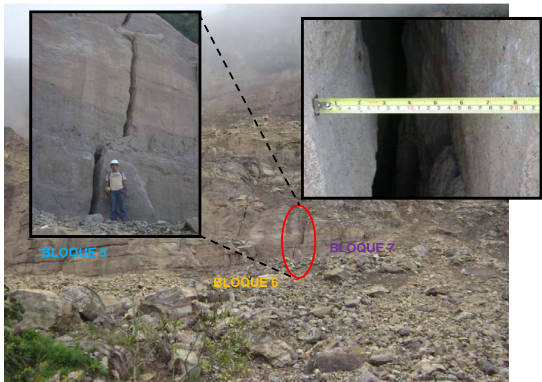
Foto 21. Fisura C, entre los bloques 6 y 7. Imagen tomada desde el BM 1, las coordenadas de la fisura son: 1232595N; 1115325E. Fuente: Investigación de los autores, 2008.
