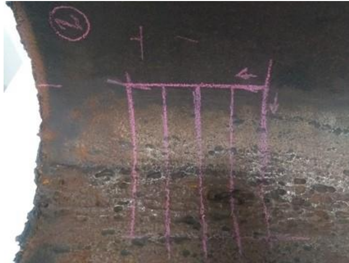
Figura 109. Tubo para inspección de corrosión Tubería API 5L X42.
