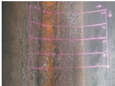
Figura 23. Tubo con pérdida de espesor
