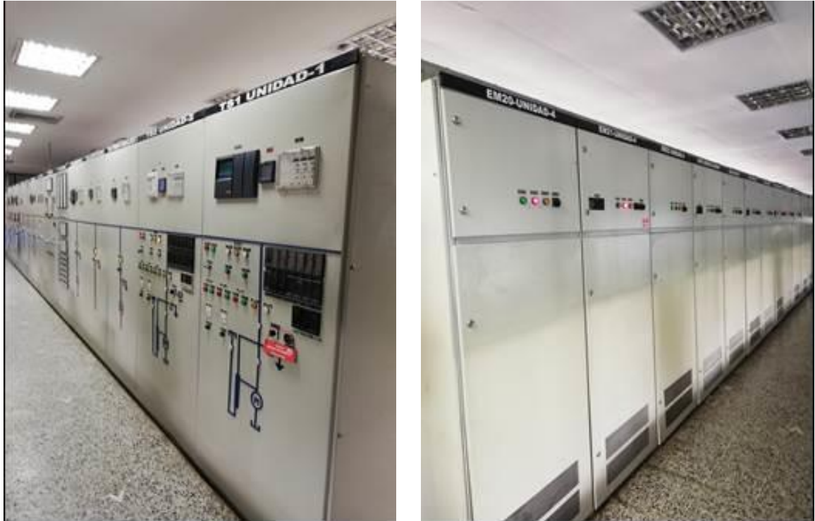
Figura 3. Tableros de supervisión y celdas de potencia. Estación de bombeo Bosconia
