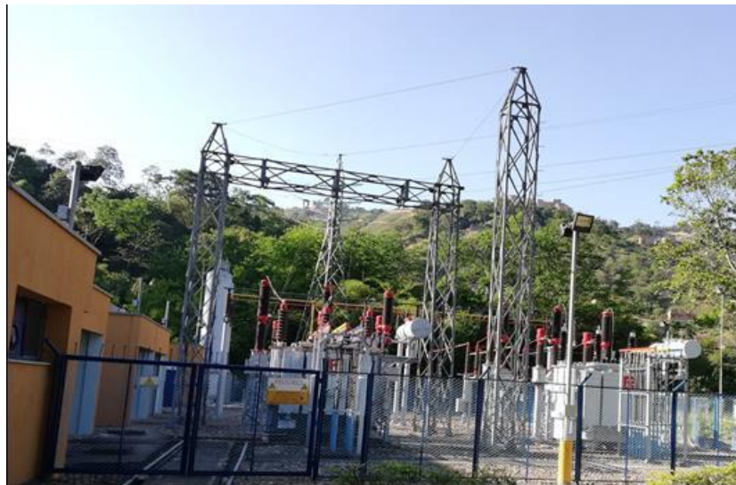
Figura 1. Subestación eléctrica 115 kV. Estación de bombeo Bosconia
