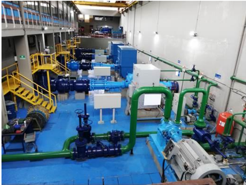
Figura 2. Casa de máquinas. Estación de bombeo Bosconia
