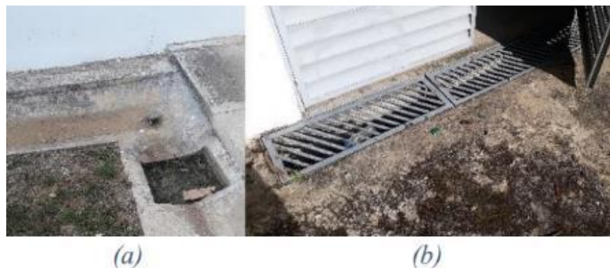
Foto 7. Canaletas, tragante, trampa de sedimentos y sumidero
