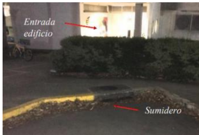
Foto 2. Localización problema de inundación
