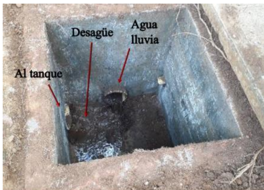
Foto 10. Caja de inspección adyacente al tanque de almacenamiento.
