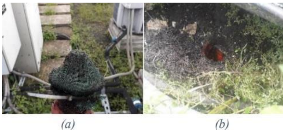
Foto 5. Tragante cúpula y tubería.
