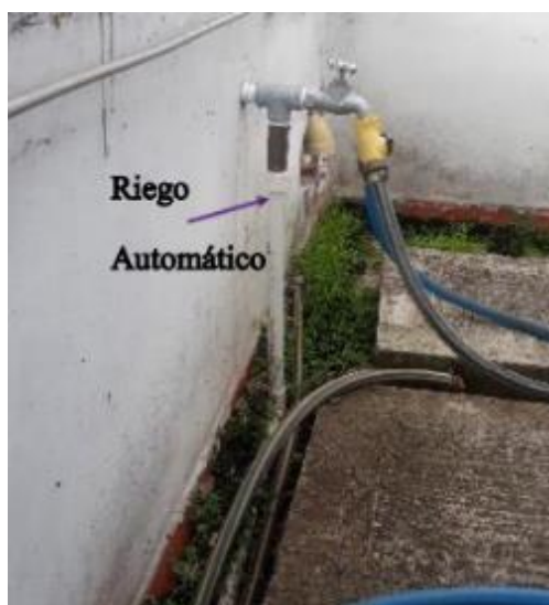
Foto 17. Llave terminal de la terraza principal.
