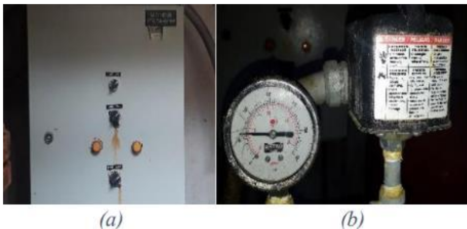
Foto 15. Tablero alternador y manómetro.
