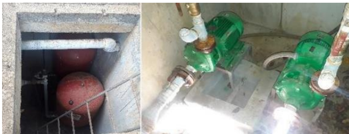
Foto 14. Bombas y tanques hidrofloplantaciones en las cubiertas verdes.
