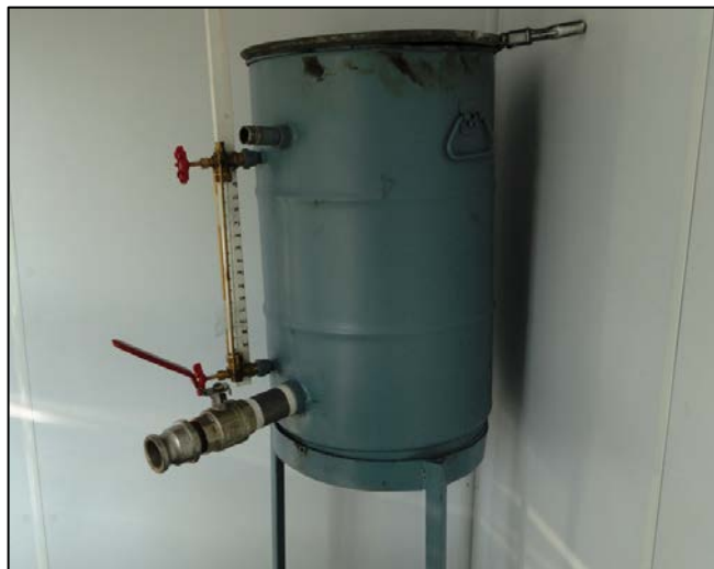
Figura 17. Tanque de pruebas
