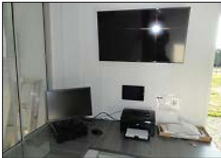
Figura 10. Cuarto de control
