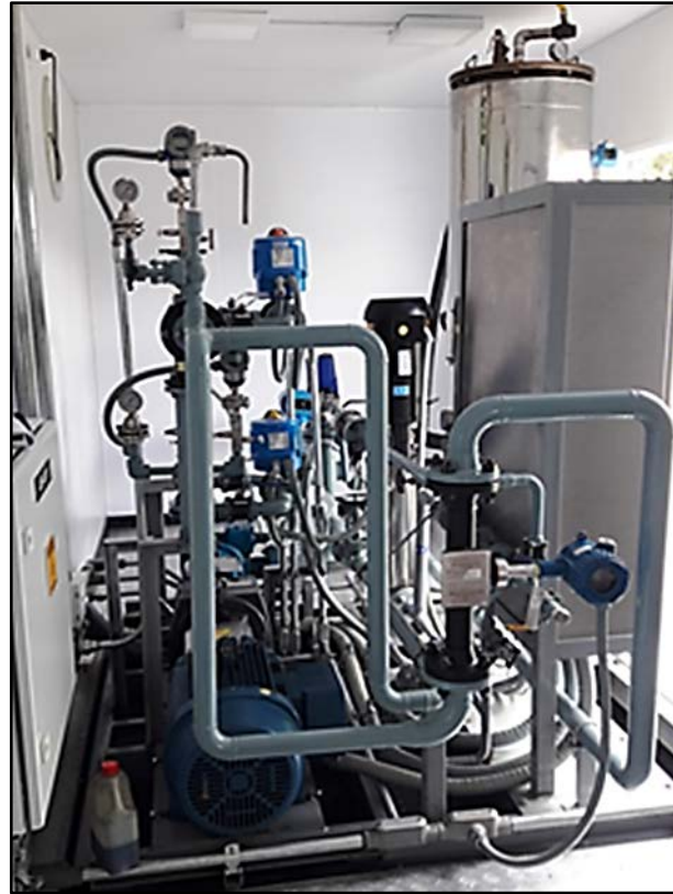
Figura 8. Patín reactor de cavitación hidrodinámica foto 2 (HCR-200-2)
