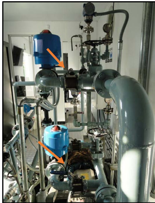
Figura 12. Válvulas control de presión PCV-001/PCV-002
