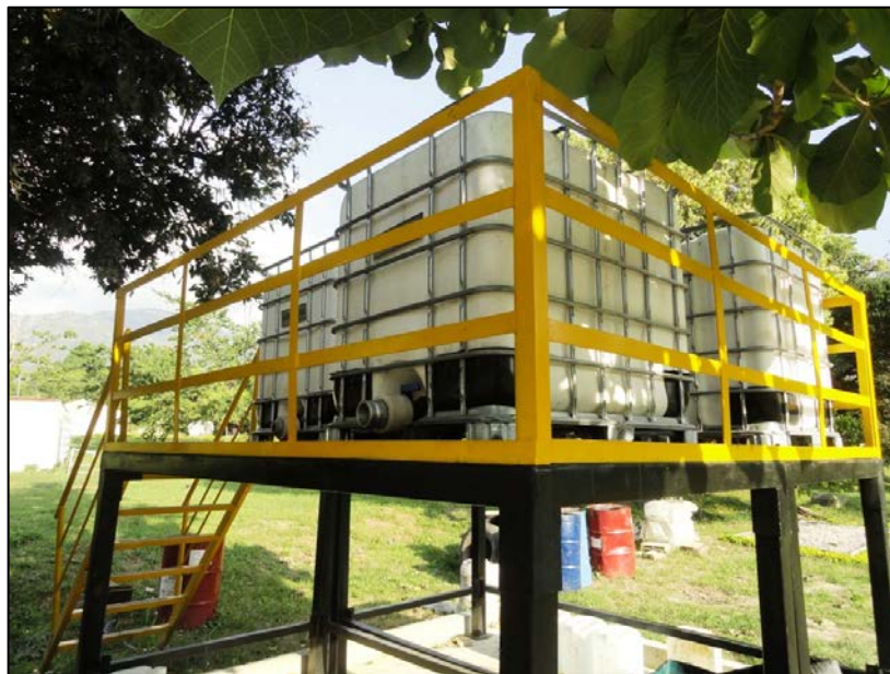
Figura 16. Tanques de almacenamiento
