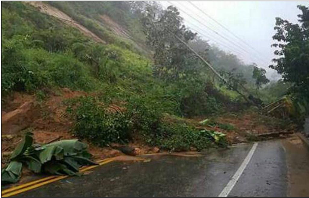
Fotografía 4. Deslizamiento planar de suelos residuales sobre plano estructural en areniscas limosas de grano fino de la formación Tablazo. Octubre 29/2016.
