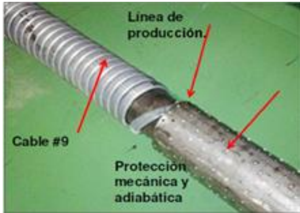
Figura 17. Cable calentador instalado en línea de flujo
