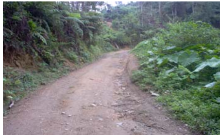
Fotografía 4. Carretera de acceso Altagracia parte alta
