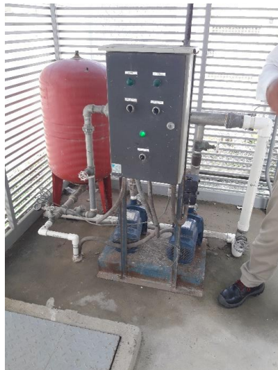
Figura 18. Sistema hidroneumático ubicado en la EDS/TDC Montecarmelo
