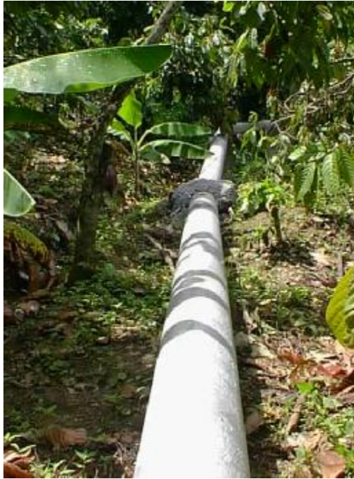
Fotografía 3. Tubería de transporte o conducción
