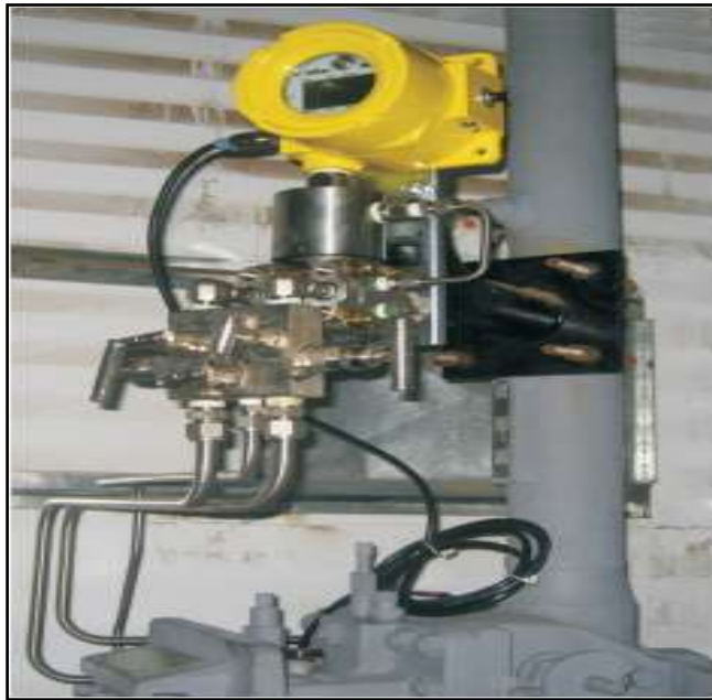
Figura 6: Medición de gas por presión diferencial
