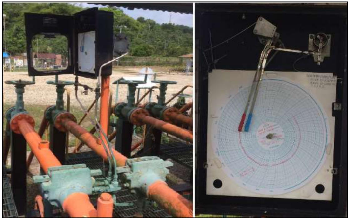
Figura 12: Medidor Primario “Daniel Junior”. Gasoducto gas de Salinas en Zona industrial.
