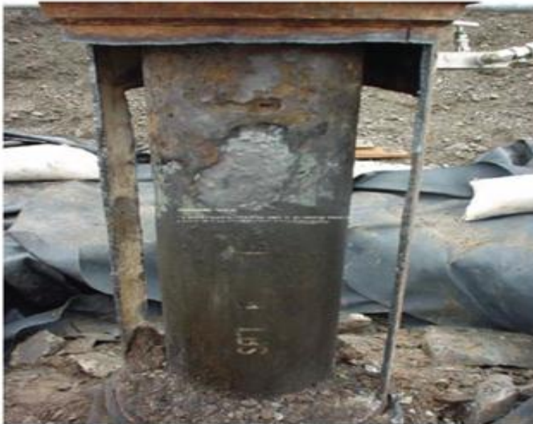
Figura 38. Reducción de espesor de pared por corrosión de tubería
