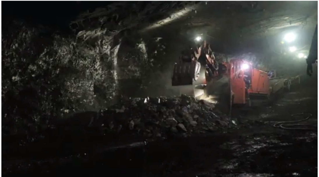
Figura 28. Centro de Acopio en frente de la Retroexcavadora Eléctrica y/o Mucking
