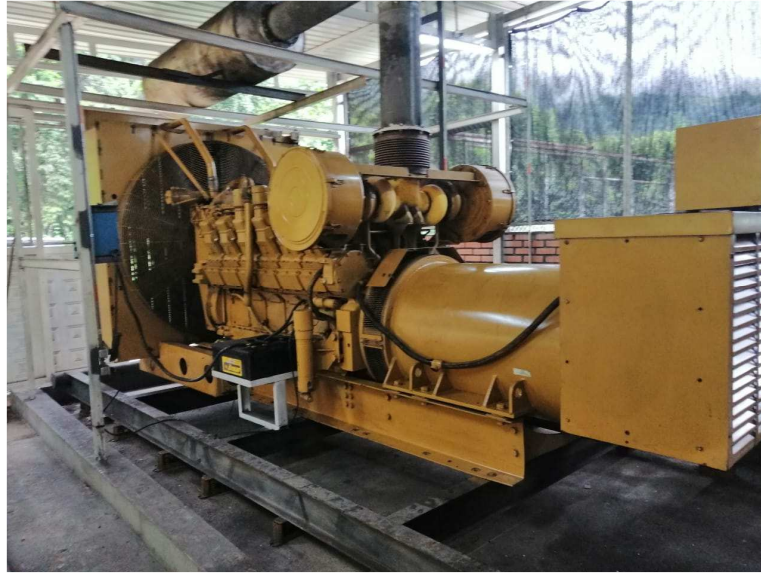
Figura 16. Generador Caterpillar 3512 (Fuente de Autor)
