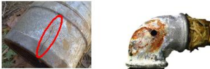
Figura 1. Daños en tuberías.
