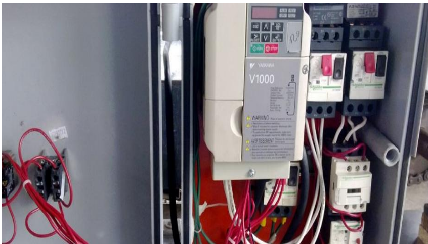
Figura 93. Variador en su caja de control
