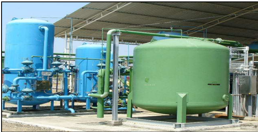
Figura 19. Planta tratamiento de agua
