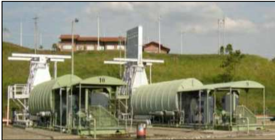
Figura 12. Generador de Vapor Estático
