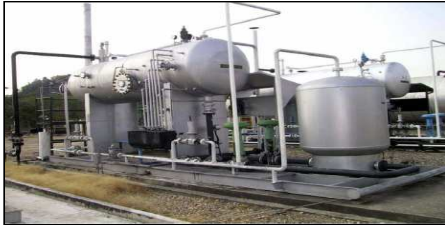
Figura 20. Separadores de prueba
