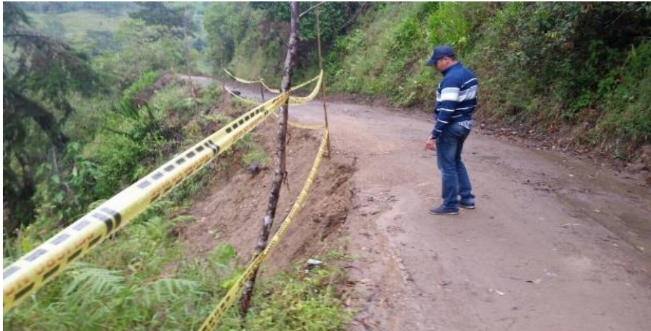
Figura 8. Daños ocasionados por la ola invernal, Chinavita Boyacá.
