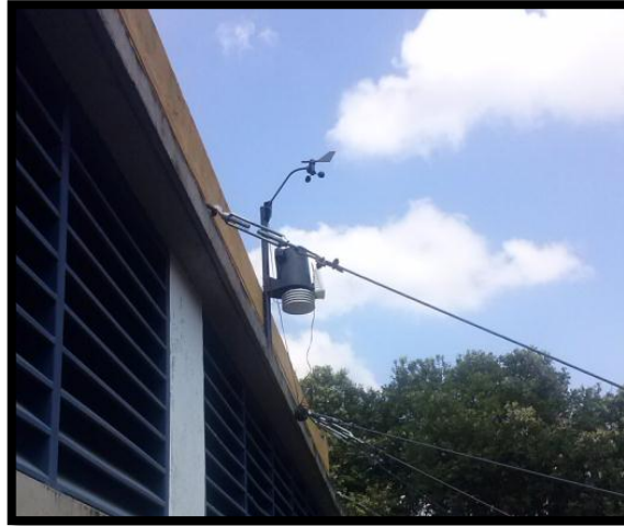
Figura 4. Estación Meteorológica No 1 ubicada en la Cubierta del laboratorio Hidráulica.
