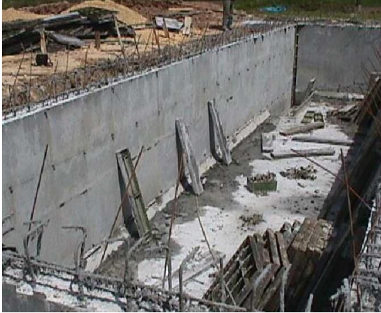
Figura 9. Planta de tratamiento de agua La Calera 66 .
