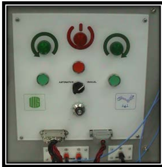
Figura 29. Tablero de control de mando del motor eléctrico
