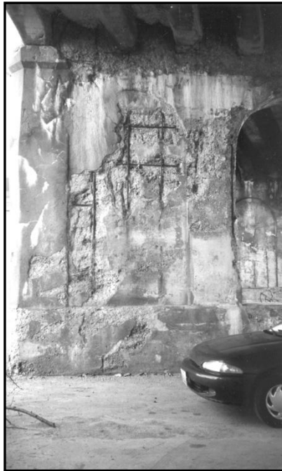
Figura No. 1: Desprendimiento del concreto en un puente ocasionado por carbonatación.
