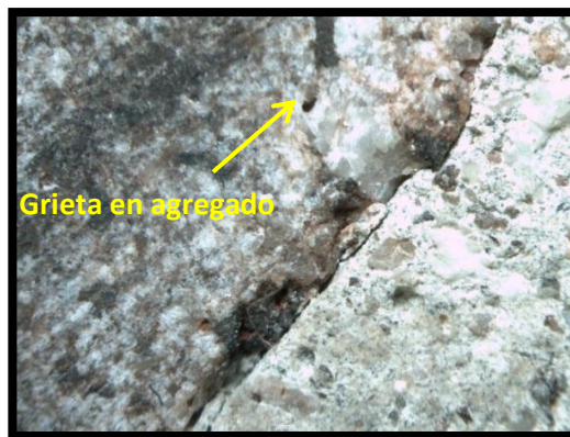
a) Agrietamiento ruptura en agregado (17x)
