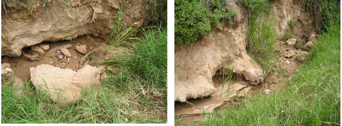
Foto 6. Deslizamiento del talud
