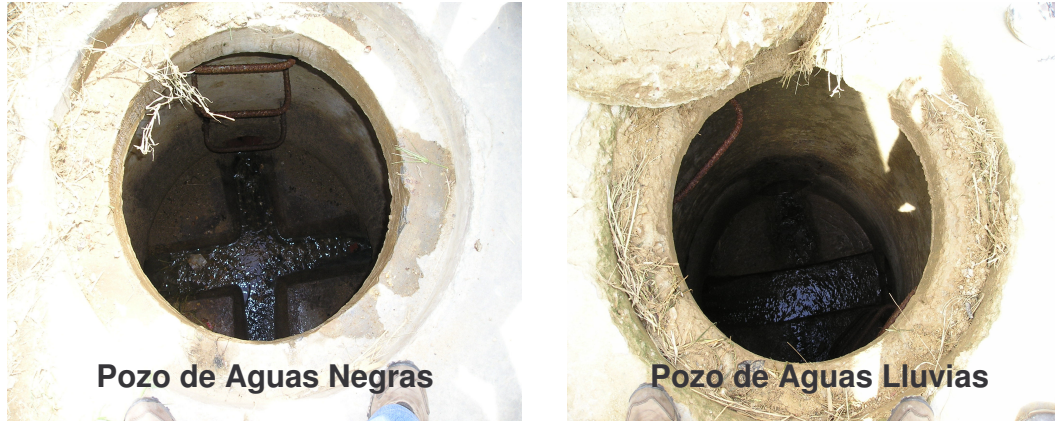
Foto 4. Pozos de Inspección
