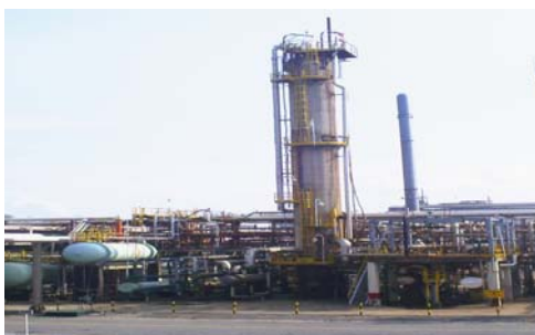
Figura 1. Torre Despojadora de Aguas agrias.
