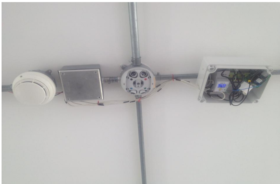
Figura 18. Ubicación del medidor monofásico YTL (UIS-ESSA).
