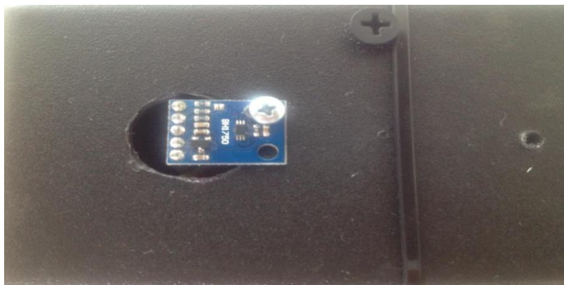
Figura 22. Instalación de los sensores de iluminancia.
