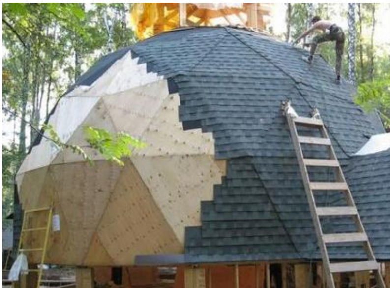
Ilustración 65. Manto térmico en el domo
