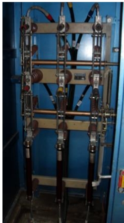
FIGURA 13: SECCIONADOR EDIFICIO PLANTA DE ACEROS
