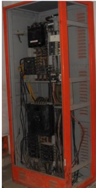
FIGURA 15: ARMARIO TABLERO GENERAL EDIFICIO PLANTA DE ACEROS
