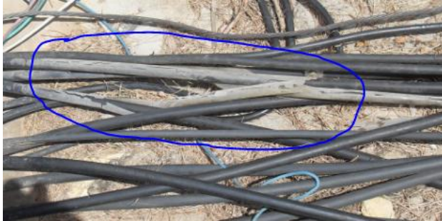
FIGURA 6: CONDUCTORES DE ALIMENTACIÓN DEL TABLERO T1
