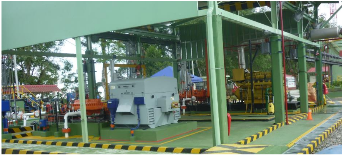
Figura 5 Estación de bombeo Herveo
