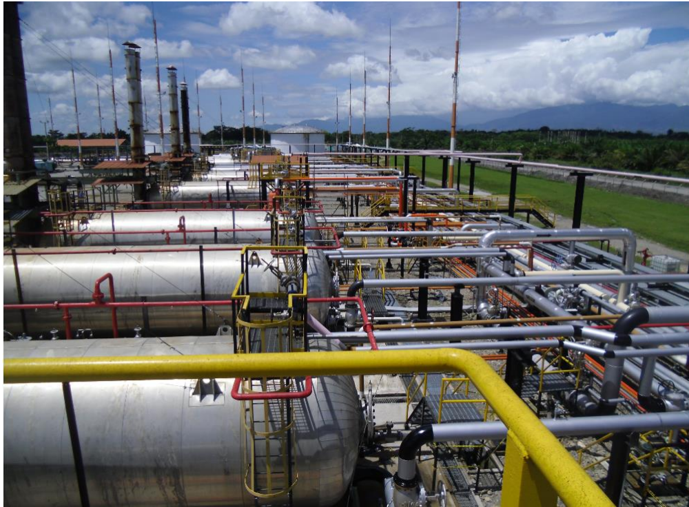
Zona de Separadores en la estación del campo de Chichimene.
