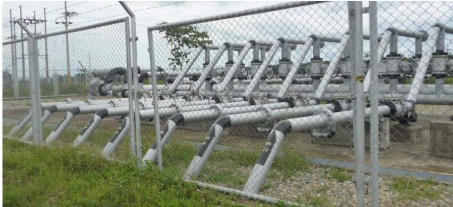
Figura 4 Manifold de plataforma ubicada en el campo de Chichimene.
