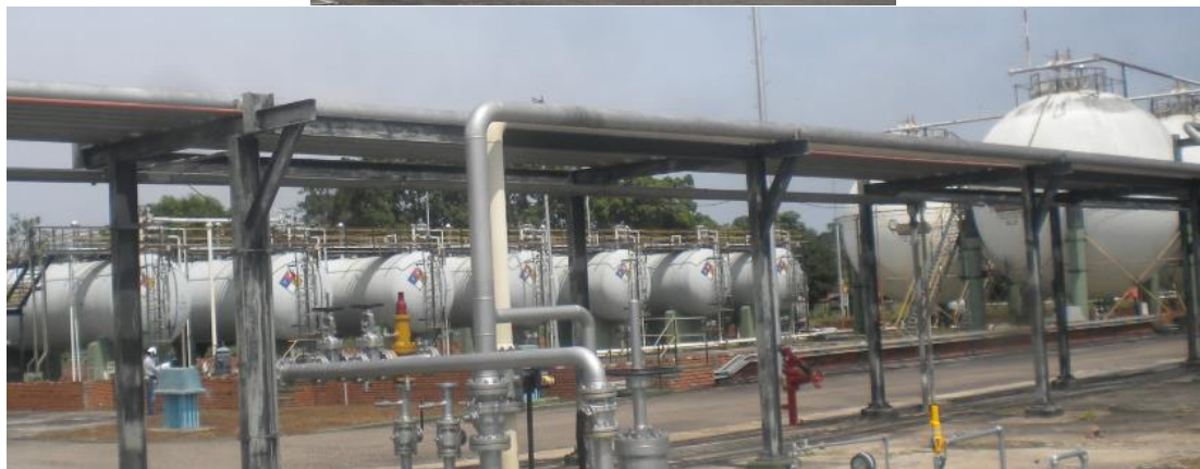
Figura 6 Estación Almacenamiento y bombeo Puerto Salgar
