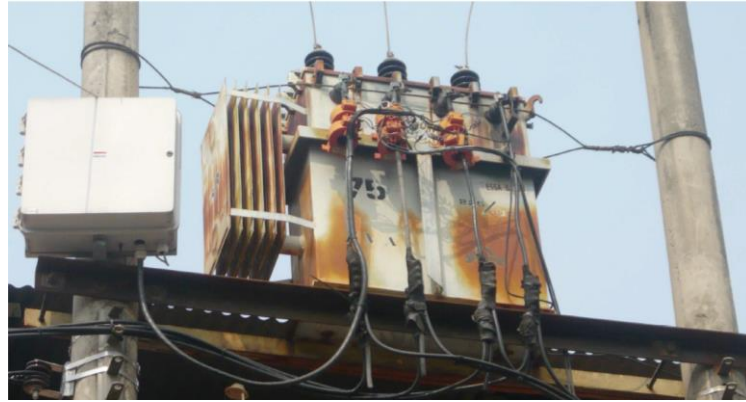
Figura 6 Transformador de distribución de la zona.
