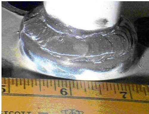
Figura 25. Vibración inducida fatiga en una brida soldada de un sistema de alivio térmico.
