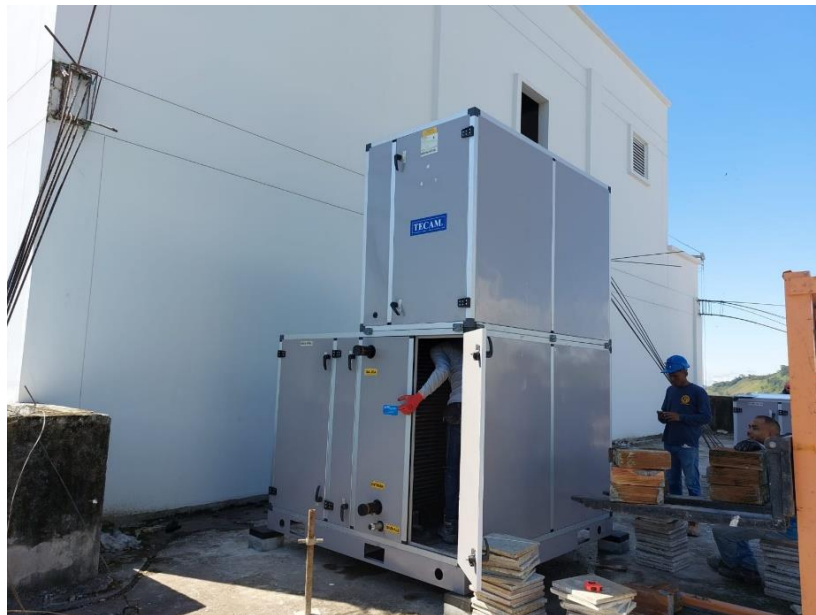
Figura 26 Instalación de la Unidad Manejadora de Aire reubicada en el piso quinto del bloque de hospitalización
