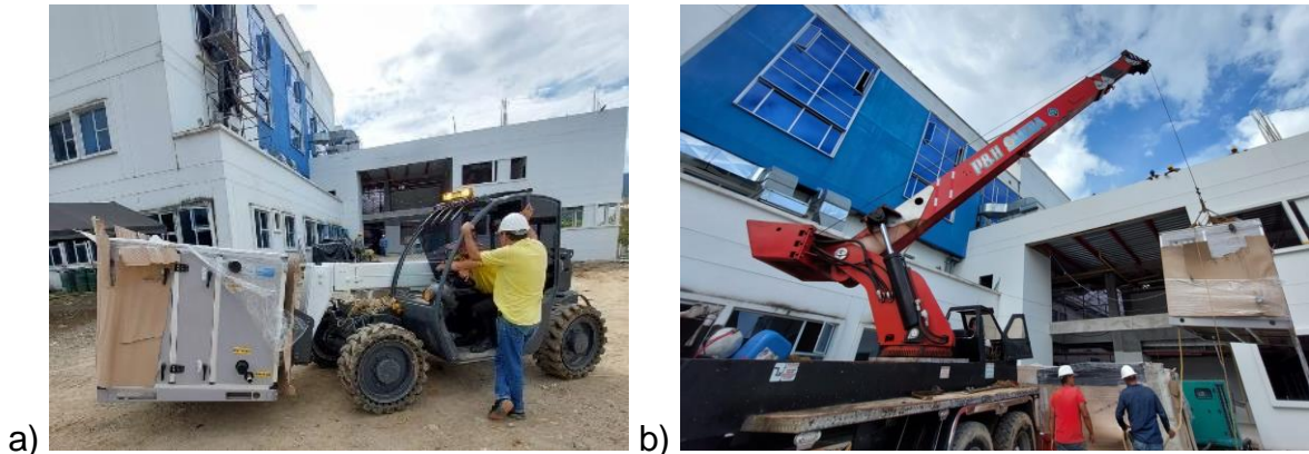
Figura 19: Traslado y movimiento de equipos de aire acondicionado con a) montacargas y b) grúa mecánica
