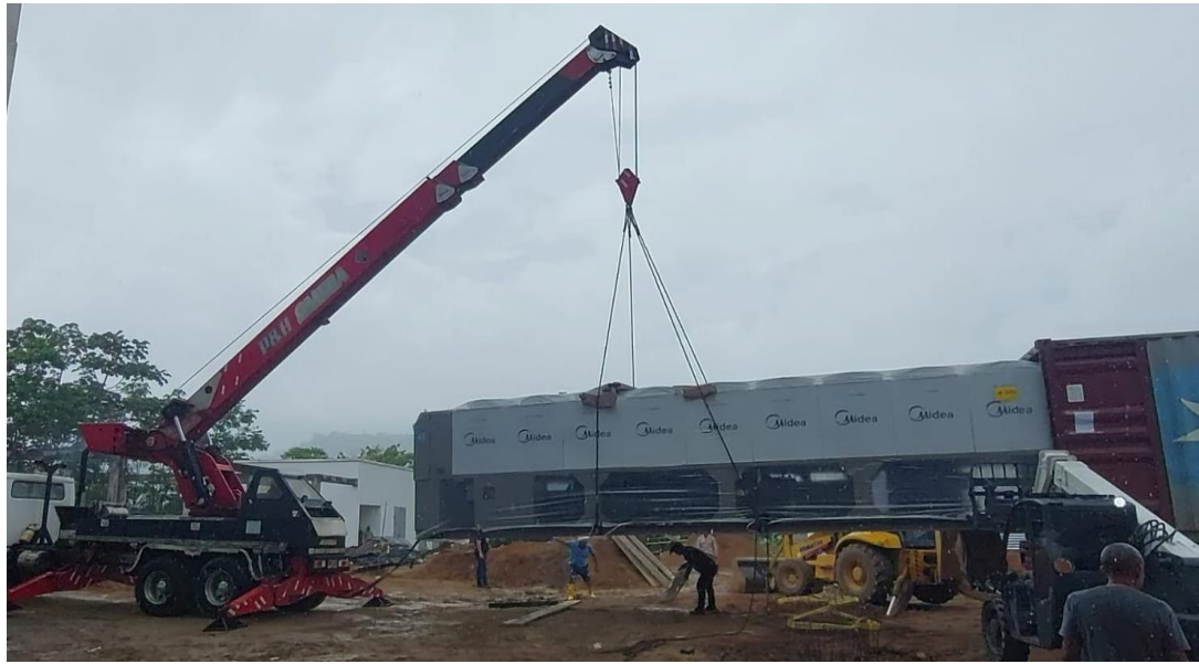
Figura 30 Descarga de chiller tipo tornillo en Hospital José María Hernández.
