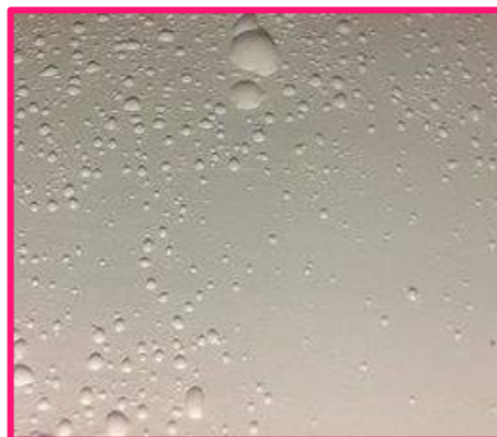
Figura 13. Presencia de ampollamientos del recubrimiento para el día 58.
