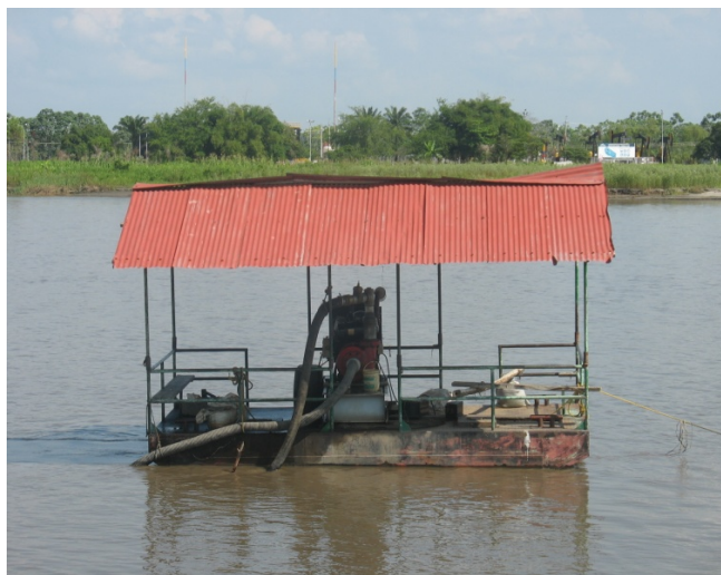
Figura 3. Captación de Agua para el Abastecimiento del Sector Urbano
