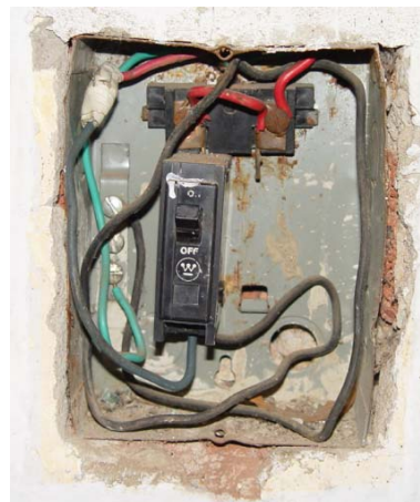
Figura 8. Barraje del tablero TD
