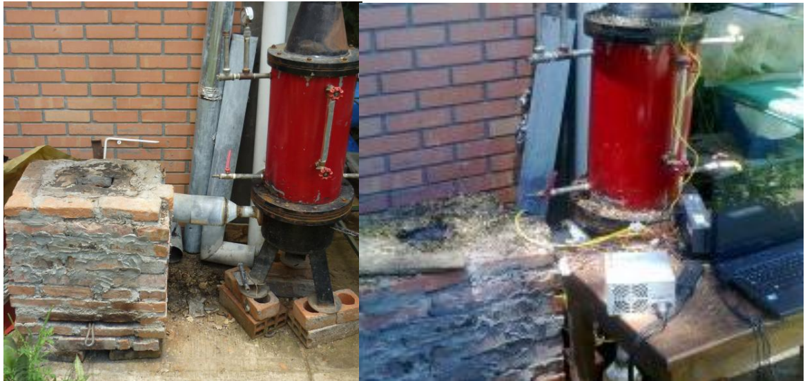
Figura 79. Montaje del prototipo del horno, la caldera y el FielPoint
