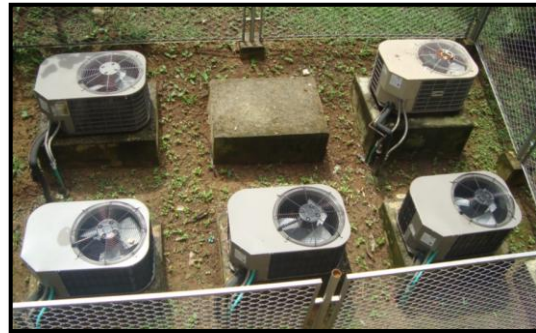
Foto 6. Aire Tipo Chiller, Ingeniería de Sistemas.
