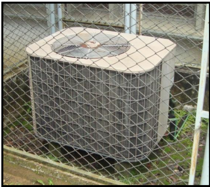
Foto 5. Aire Tipo Chiller, FAVUIS.
