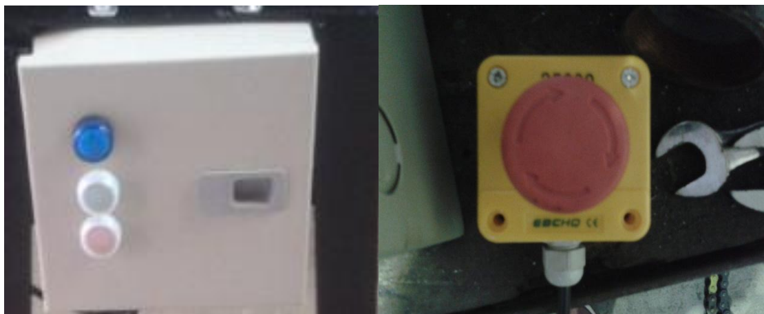
Figura 65. Caja de control y pulsador de Seguridad
